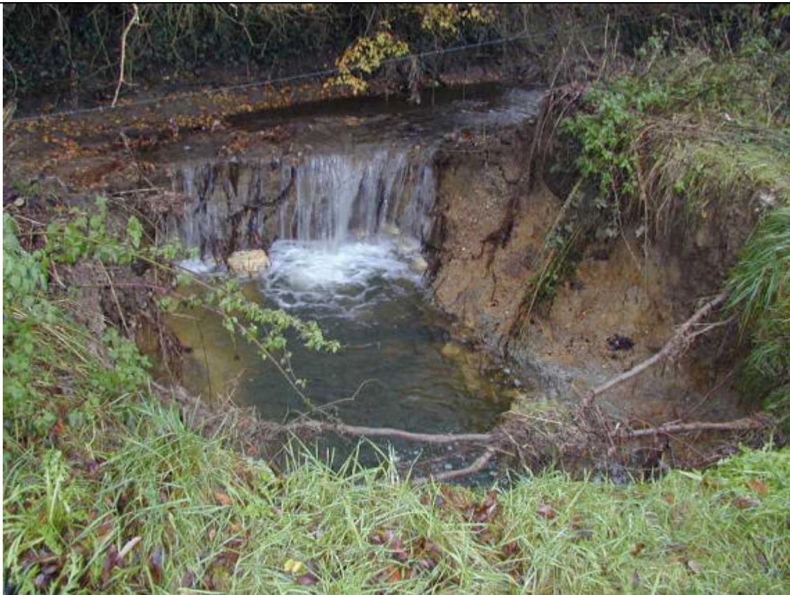
Photo 5 : Perte dans le lit du Pas-Sicard en amont du Pont d'Augrain, aujourd'hui rebouchée (cliché SDAEP 44 - Décembre 2003)
