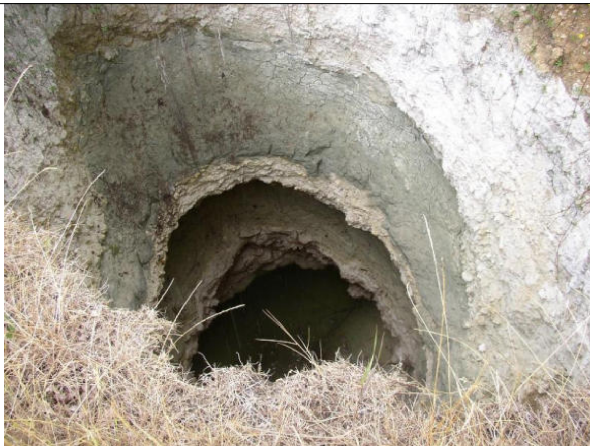
Photo 9 : Effondrement à la Chutenaie (cliché GEOARMOR – juillet 2003)
