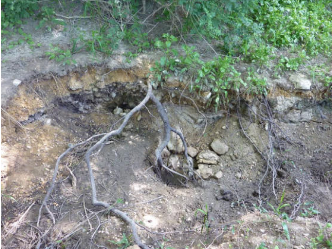
Photo 15 : Entonnoir résiduel d'une zone d'émergence dans le lit de l'Isac – Mai 2011
