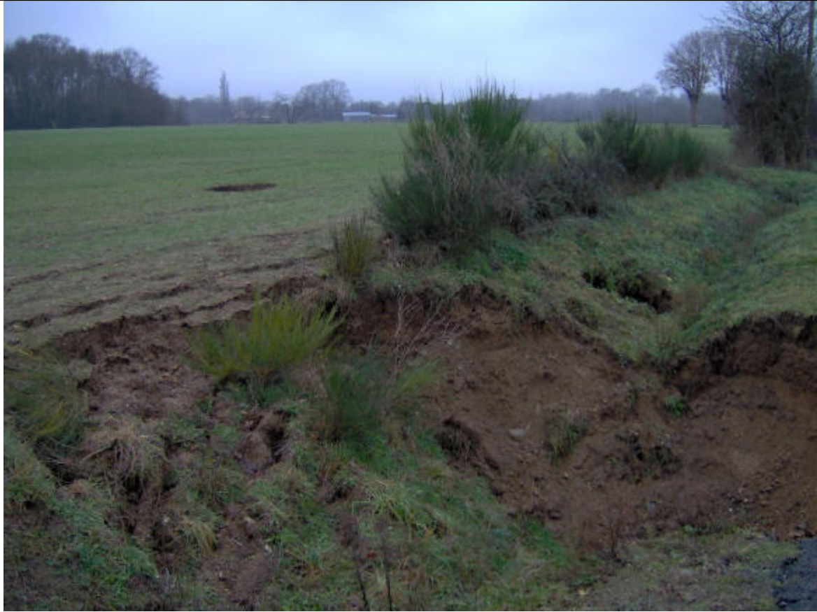
Photo 11 : Autres effondrements aux Petits Frênes (cliché J. de Bouard – Janvier 2006)
